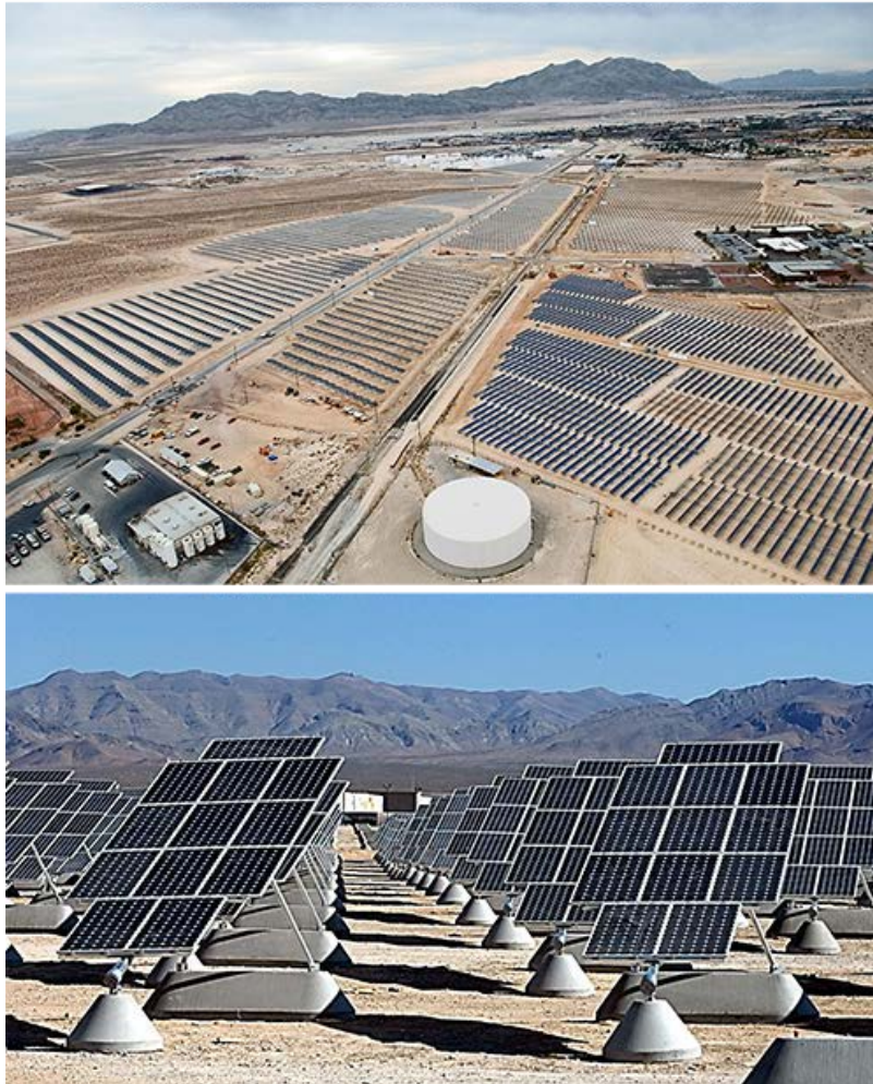
Fig. 17 - Nellis Air Force Base 140-acre solar farm
